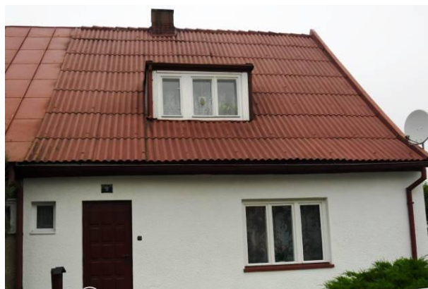
Rys. 6. Pokrycie dachowe ocenione w III stopniu pilności.
