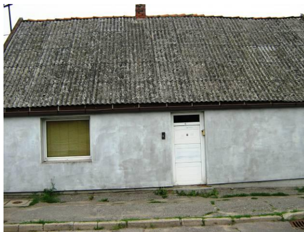
Rys. 7. Pokrycie dachowe ocenione w II stopniu pilności.
