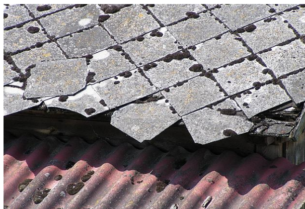
Rys. 8. Pokrycie dachowe ocenione w I stopniu pilności.
