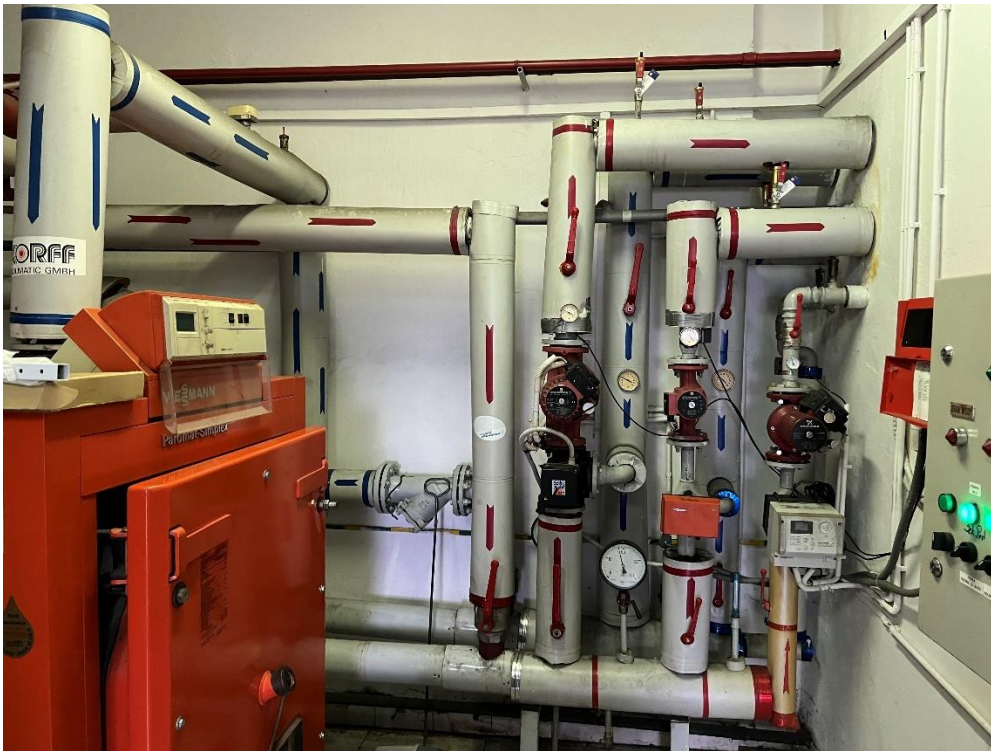
Zdjęcie 4 Kotłownia olejowa – awaryjne źródło ogrzewania.
