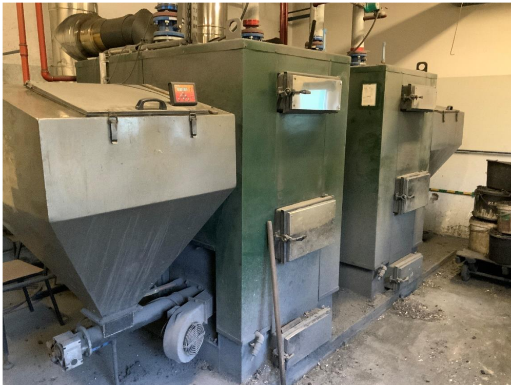
Zdjęcie 3 Kotłownia węglowa
