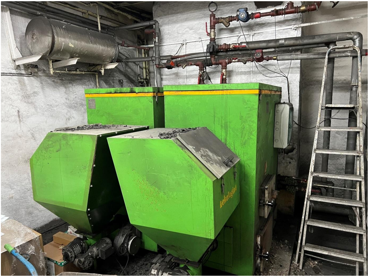
Zdjęcie 3 Kotłownia węglowa
